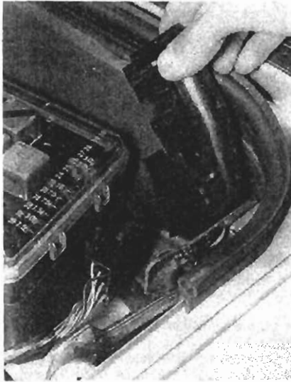
Desmontaje del protector del conector fijado a la caja de fusibles.
